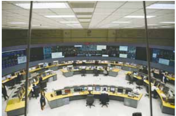
圖 6-7 台北捷運高運量行車控制中心
