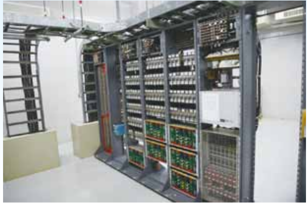
圖 6-6 台北捷運高運量淡水線復興崗站號誌設備室
