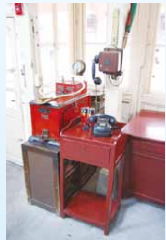
圖 6-1 電氣路牌閉塞器（平溪線菁桐站）
