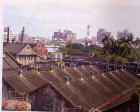
通風設施是舊台中酒廠的重要設施與景觀。
