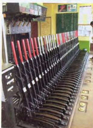
珍貴的基隆車站號誌樓是鐵道文化愛好者與文建會協力搶救的成果。
