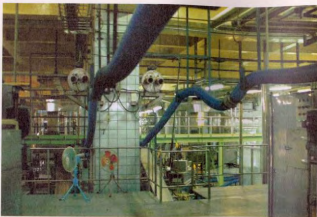
新台中酒廠亦是處處管線。
