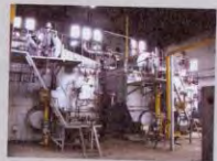
舊台中酒廠的鍋爐。
