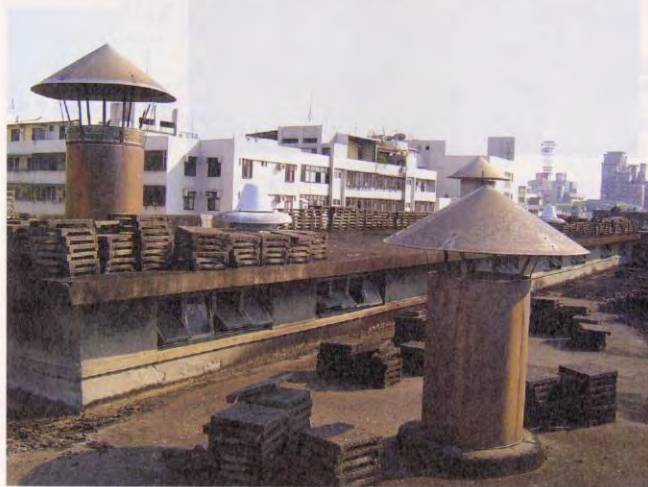
舊台中酒廠的通風設備。
