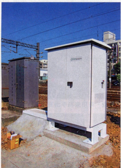
鐵路號誌亦須設置備用電力。 (圖為台鐵中壢分駐所號誌備用電力)
